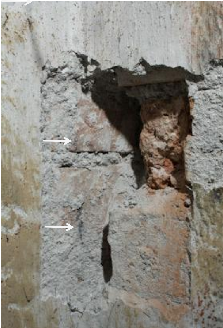
An dieser Stelle wurde eine größere Öffnung mit Ziegeln vermauert (stumpfe Anbindung). Der Bleistiftstrich mit dem die Flucht für die Vermauerung angerissen wurde, ist noch deutlich erkennbar (Pfeil)
