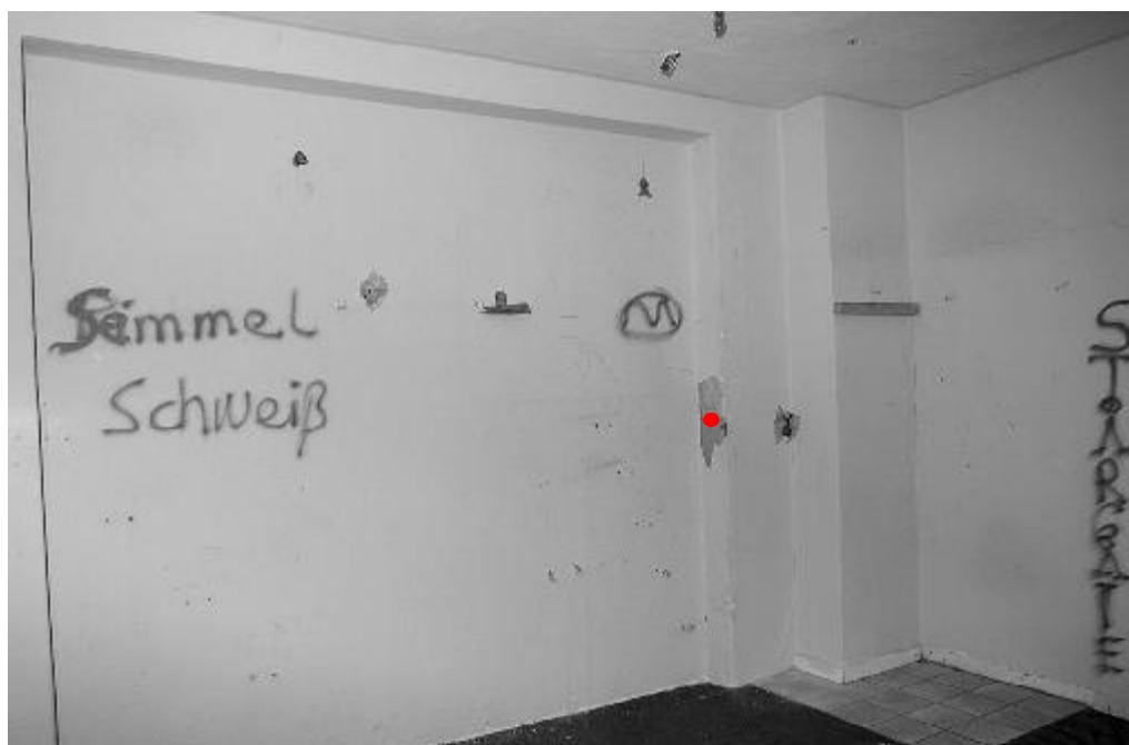
Der rote Punkt zeigt die genaue Lage der Befundstelle (Grundriß oben und Wandansicht unten)
