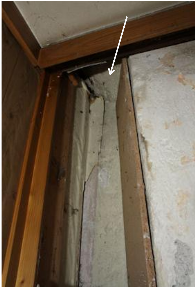
Nach der Abnahme einer aufgesetzten Rigipsplatte wurde der rechte Abschluss der Nische (Zimmer 1.3) sichtbar.
